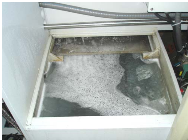
图8-11 排气调整后的冲洗阶段泡沫
